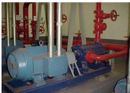
Figura 58 - Bomba de pressurização
