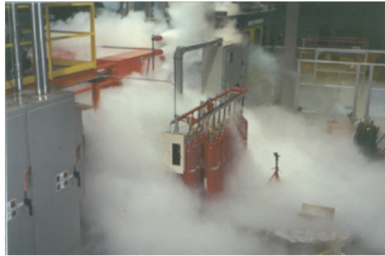
Figura 68 - Sistema de CO 2 em funcionamento
