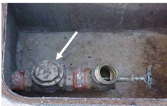
Figura 47 - Hidrante de recalque com válvula de retenção
