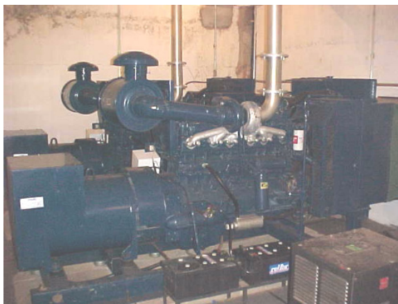
Figura 40 – Exemplo de equipamento energizado
