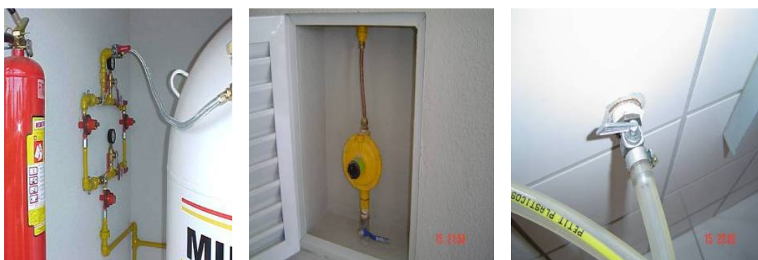
Figura 33 - Registros de corte na central, na prumada e no ponto de consumo, respectivamente
