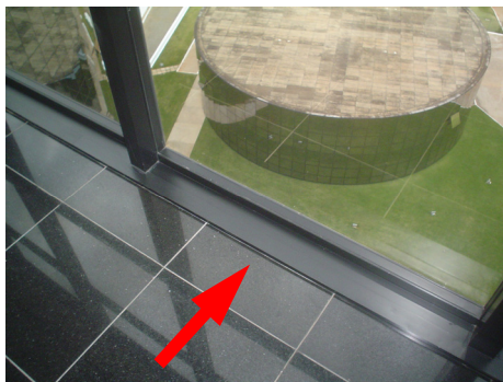
Figura 60 – Peça metálica entre o suporte dos vidros e a laje.
