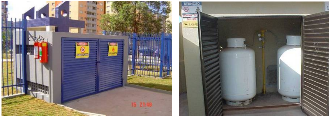
Figura 30 - Central de GLP
