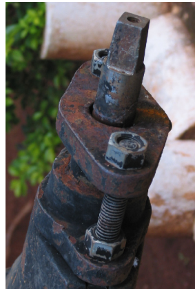
Figura 64 – Exemplo de registro da válvula do hidrante
