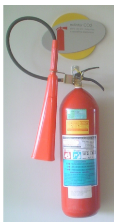
Figura 38 - Extintor sobre suporte na parede
