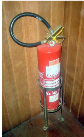
Figura 39 - Extintor sobre suporte a 0,20m do piso
