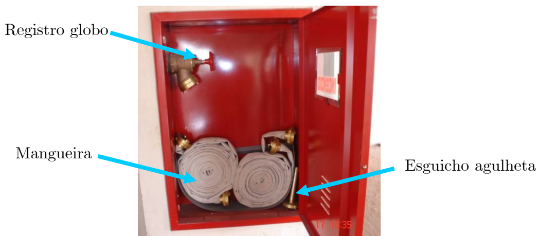
Figura 41 - Hidrante de parede
