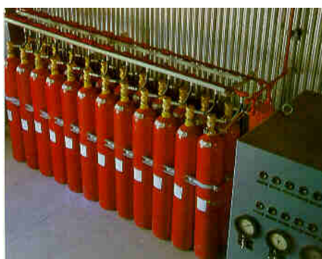
Figura 72 - Cilindros de HFC-227
