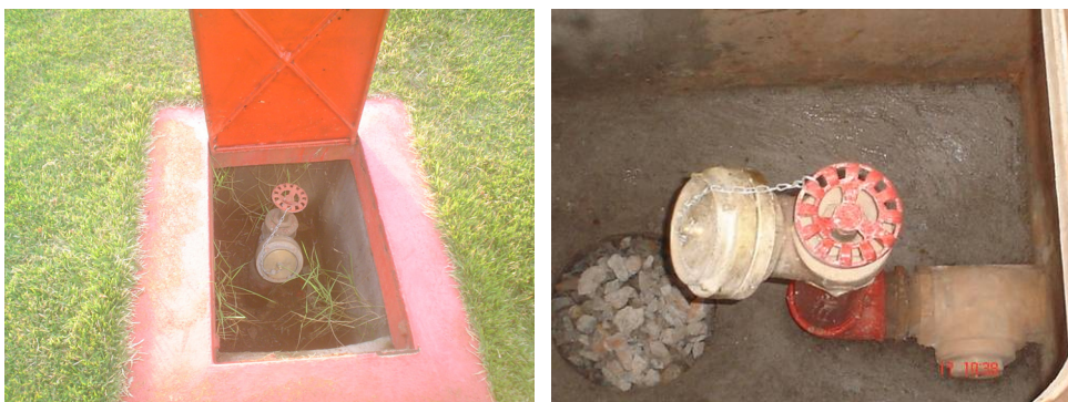
Figura 44 - Hidrante de passeio
