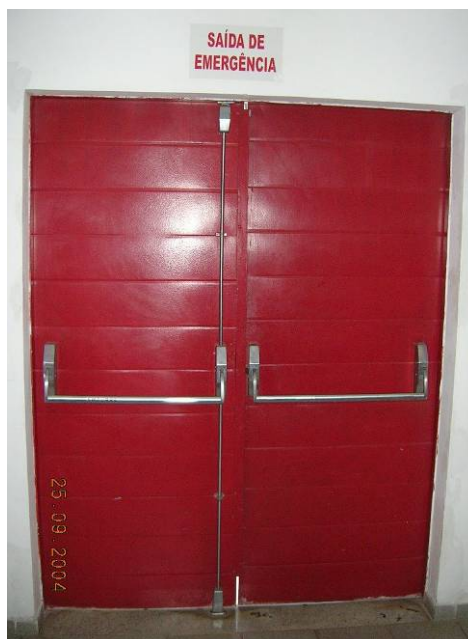
Figura 4 - Porta corta-fogo com barra antipânico
