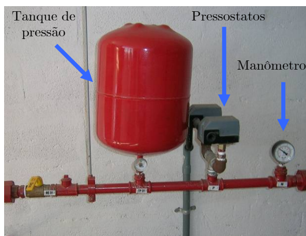
Figura 42 - Tanque de pressão, manômetro e pressostato
