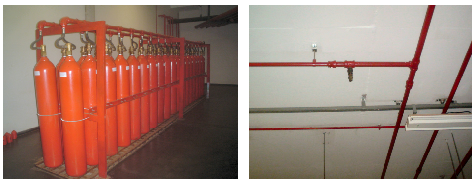
Figura 67 - Bateria de CO 2 e bico aspersor
